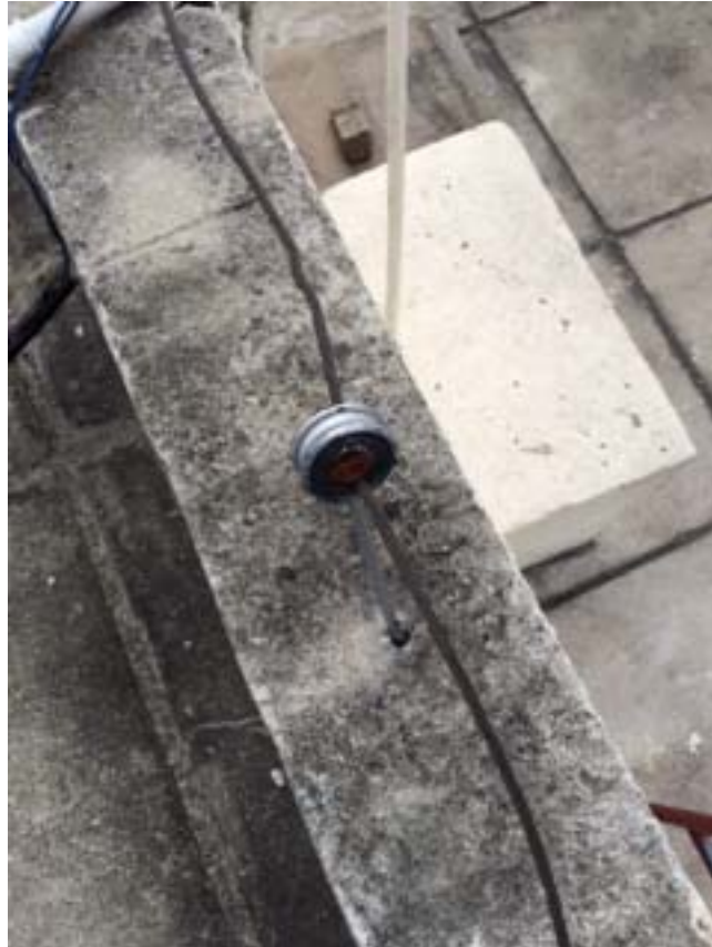
CORDOALHA DA MALHA CAPTORA FROUXA.
