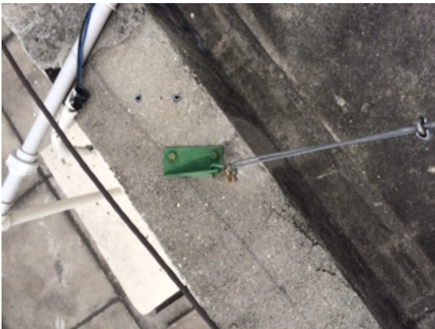
CONJUNTO DE ESTAIS DE FIXAÇÃO DO MASTRO DO PÁRA-RAIOS SEM TENSIONADOR
