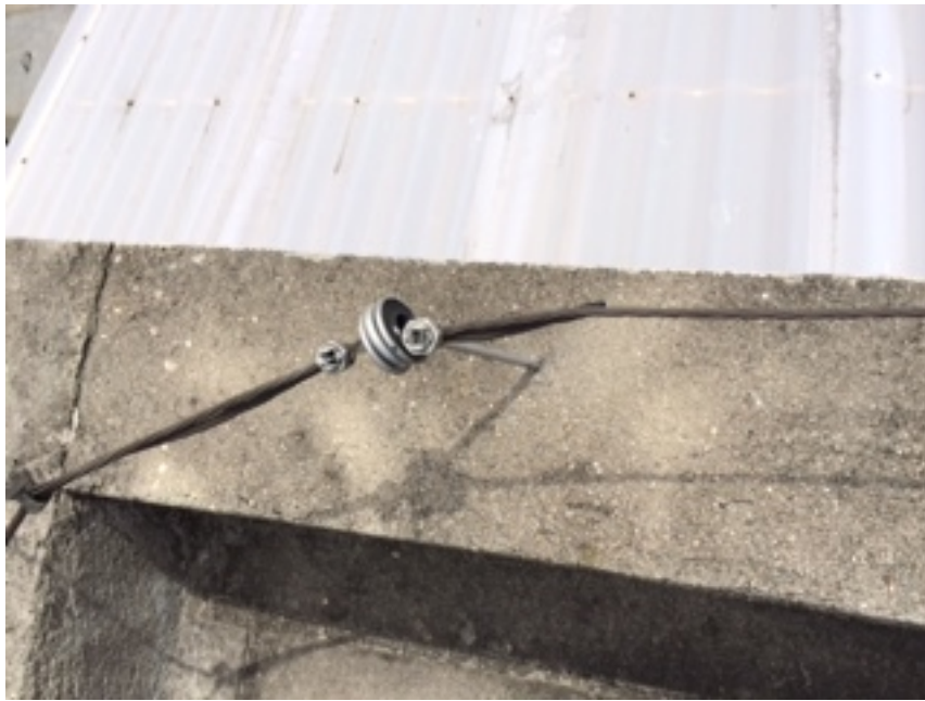
SUORTE ISOLADOR DESLOCADO
