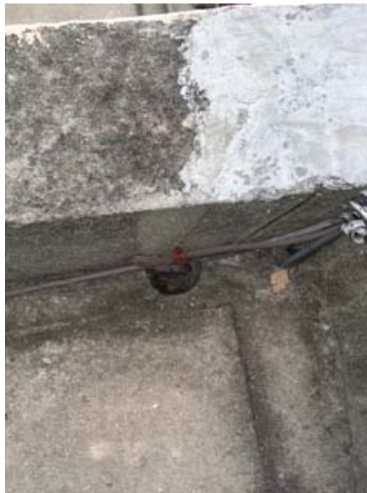
CONECTOR INAPROPRIADO NA JUNÇÃO DA CORDOALHA DA MALHA CAPTORA
